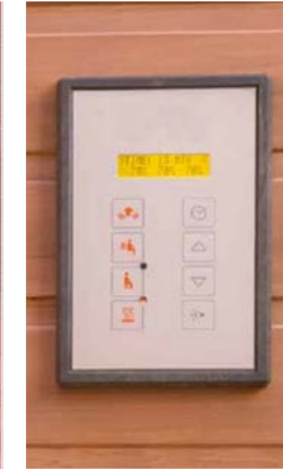
Die Steuerung wurde weiterentwickelt und regelt auch die Bodenheizung und Beinstrahler
