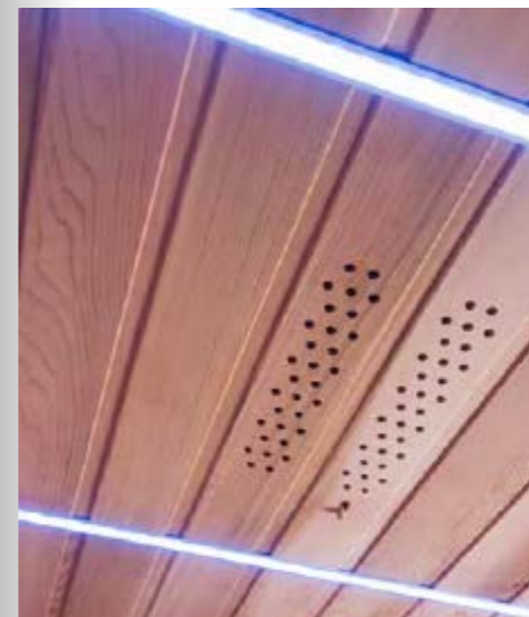
Entlüftungsschieber in der Decke
